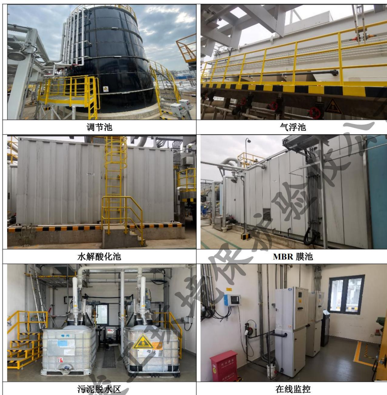
图 4.1-2 污水处理站现场照片
