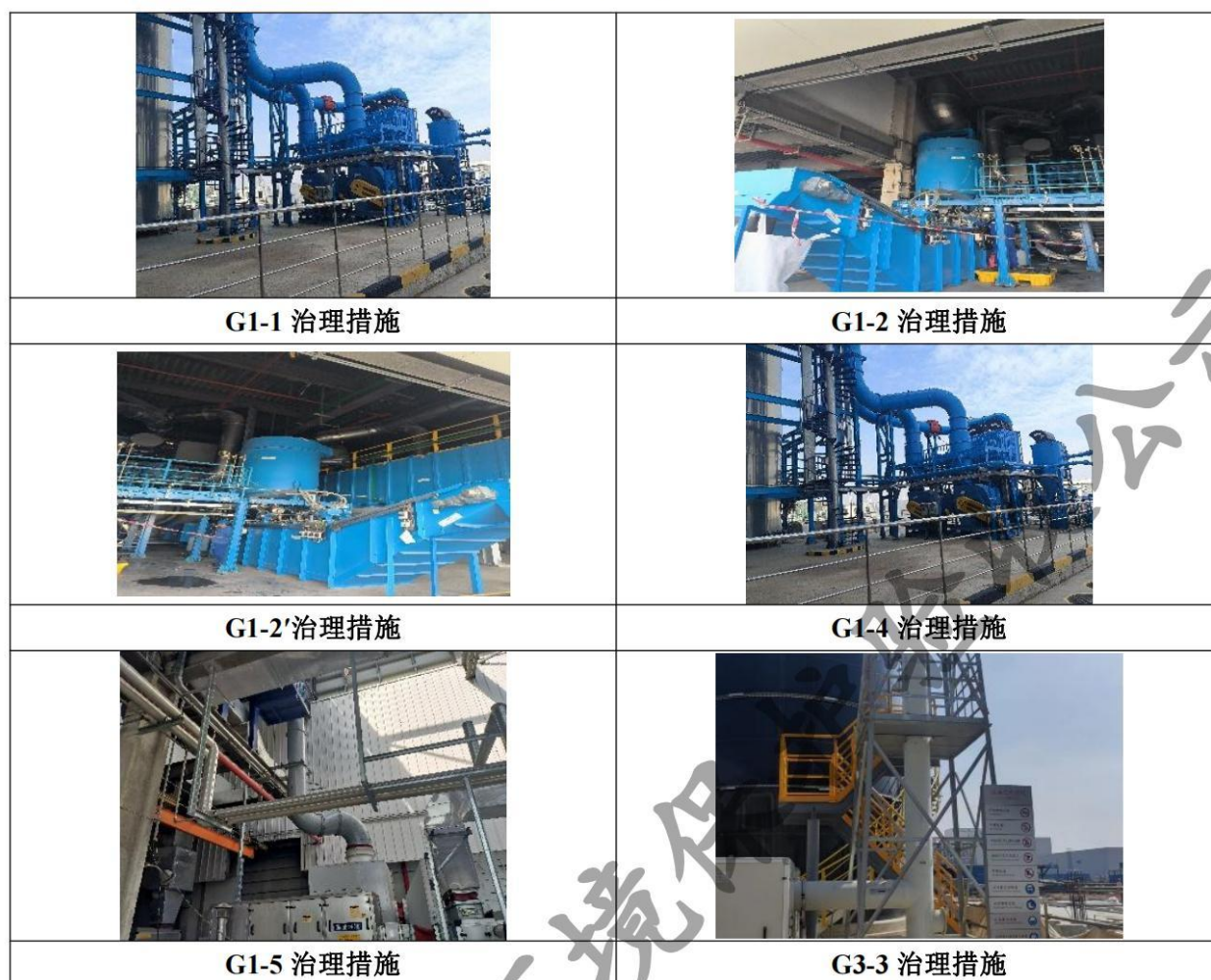
图 4.1-4 废气治理设施现场图
