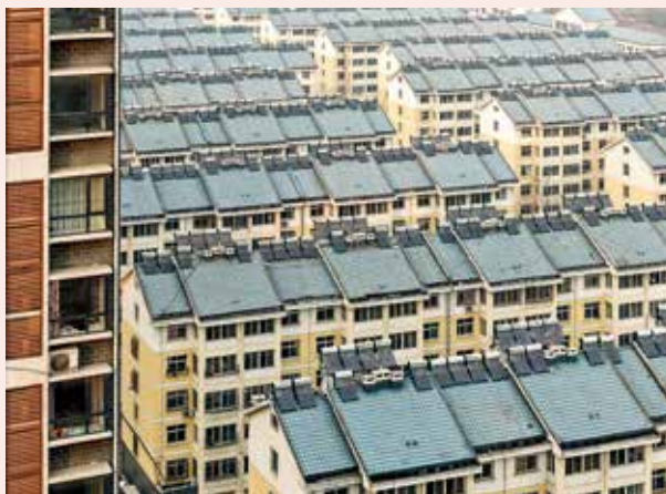
太阳能在中国的开发和利用：位于德州的日月坛微排大厦是全球最大的太阳能建筑（上图）。集热器价格并不高，城市中许多居民均使用太阳能热水器（下图）。
