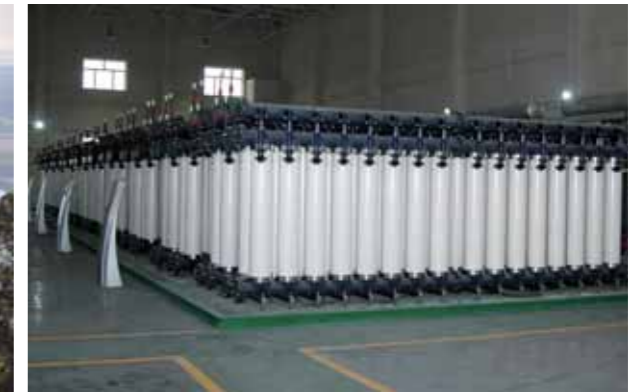
工程项目：大庆油田饮用水处理 解决方案：巴斯夫inge®dizzer®XL 0.9 MB 60W 膜元件 及T-Rack® vario 机架
