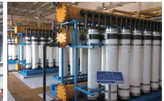
工程项目：首都机场奥运配套污水回用 解决方案：巴斯夫inge®dizzer®5000 plus膜元件
