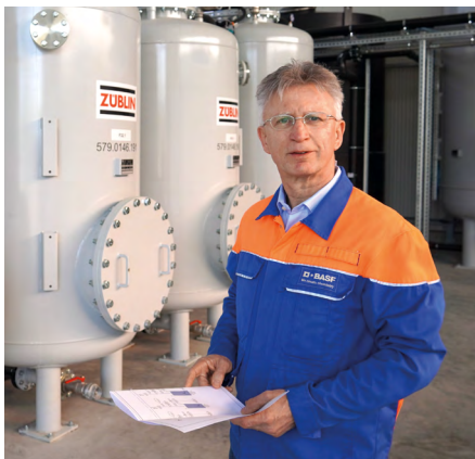
Projektleiter Livio Ulmann bei einem Funktionstest der Grundwasserreinigungsanlage.
