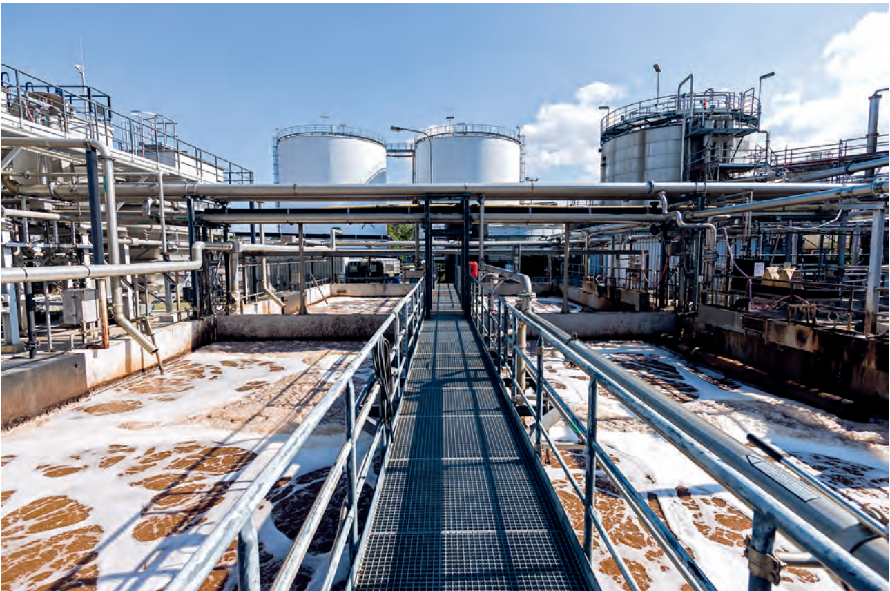
Kläranlage der BASF Lampertheim GmbH
