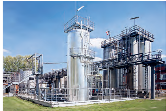
Lager für flüssige Chemikalien
