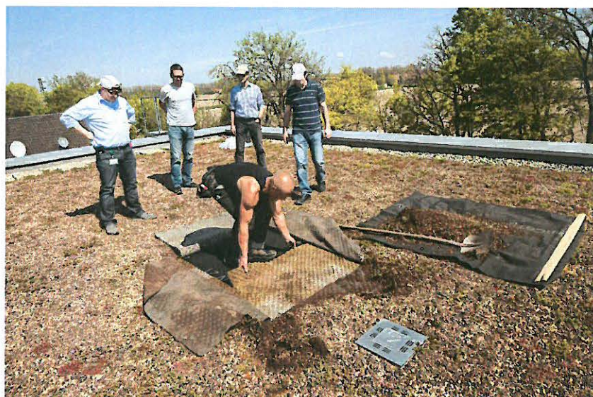
Bild 2: Entnahmestelle 2 - Richtung Süd – Ost unmittelbar Neben einem Dachabfluss
