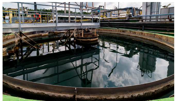
Una vasca dell'impianto di depurazione acque presso lo stabilimento di Pontecchio Marconi (BO).
